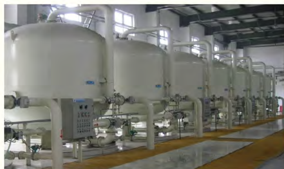
活性炭过滤器
