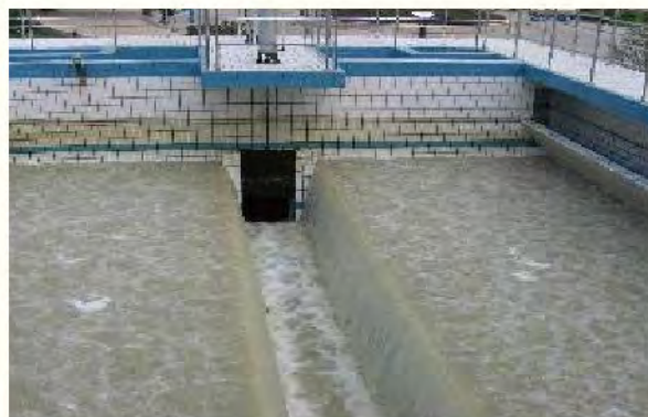
V型过滤池
